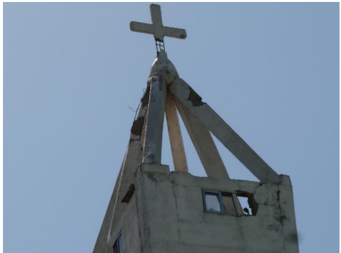
Beschädigte Kirche in Mubi
